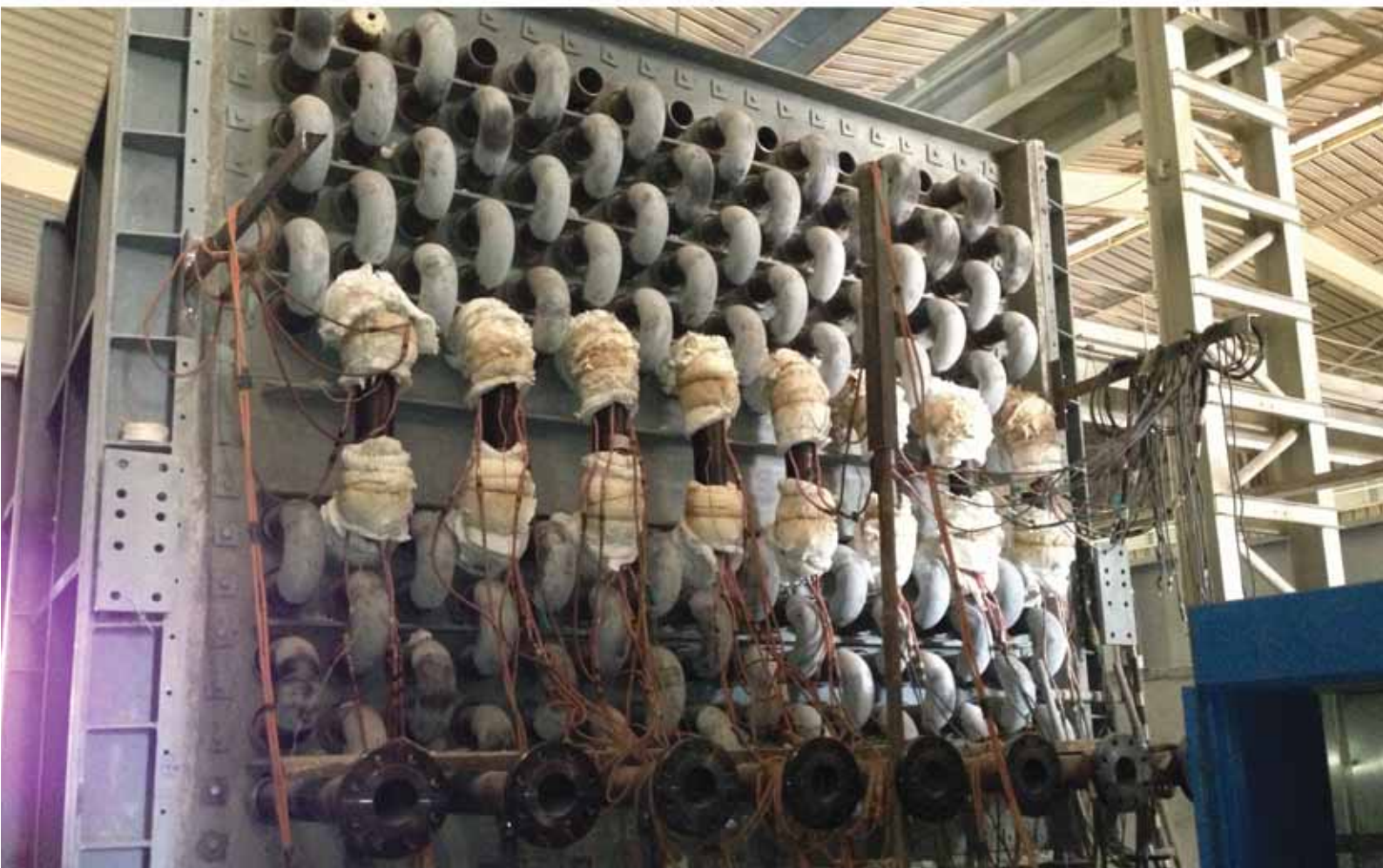
TR - TÜPRAŞ PIPING
