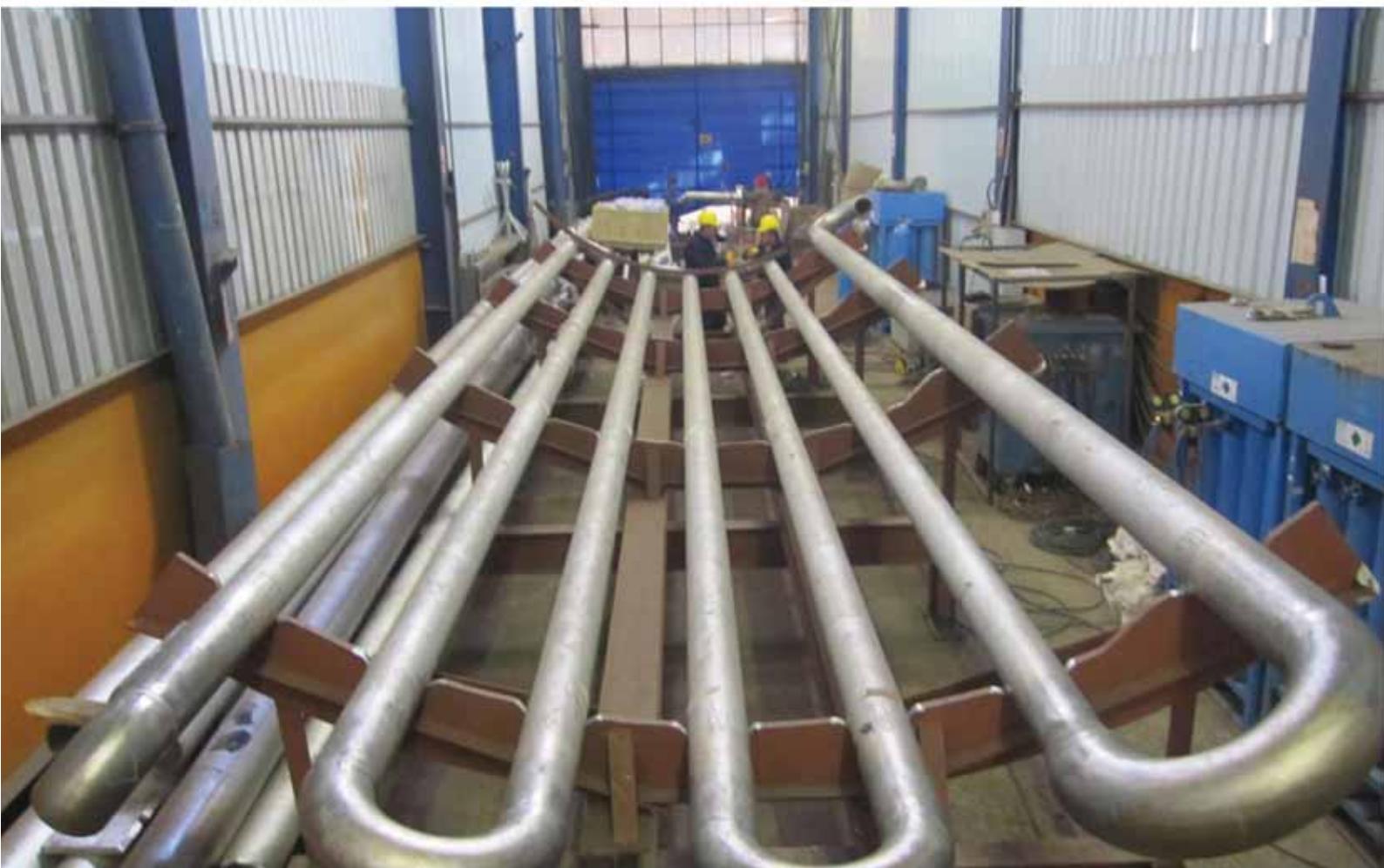
TR - TÜPRAŞ PIPING
